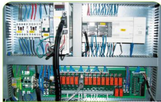
電控系統 Electrical system
